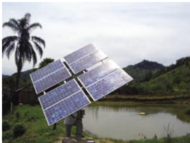
Rastreador solar instalado em Magé (RJ)
