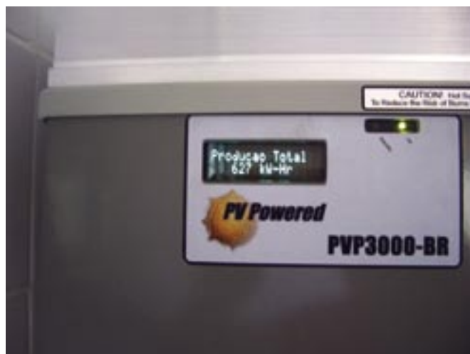
Indicação do mostrador do inversor com a energia poupada em um mês
