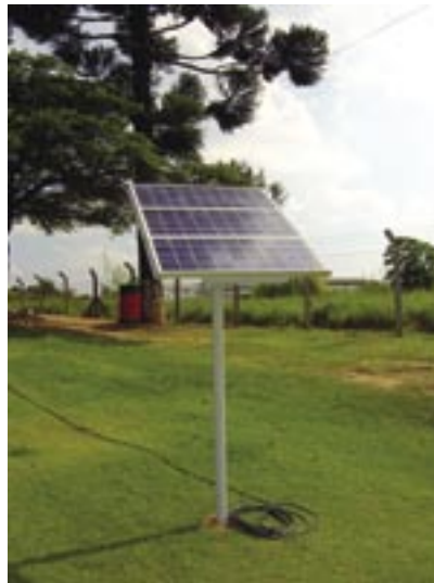
Sistema bombeamento d'água
